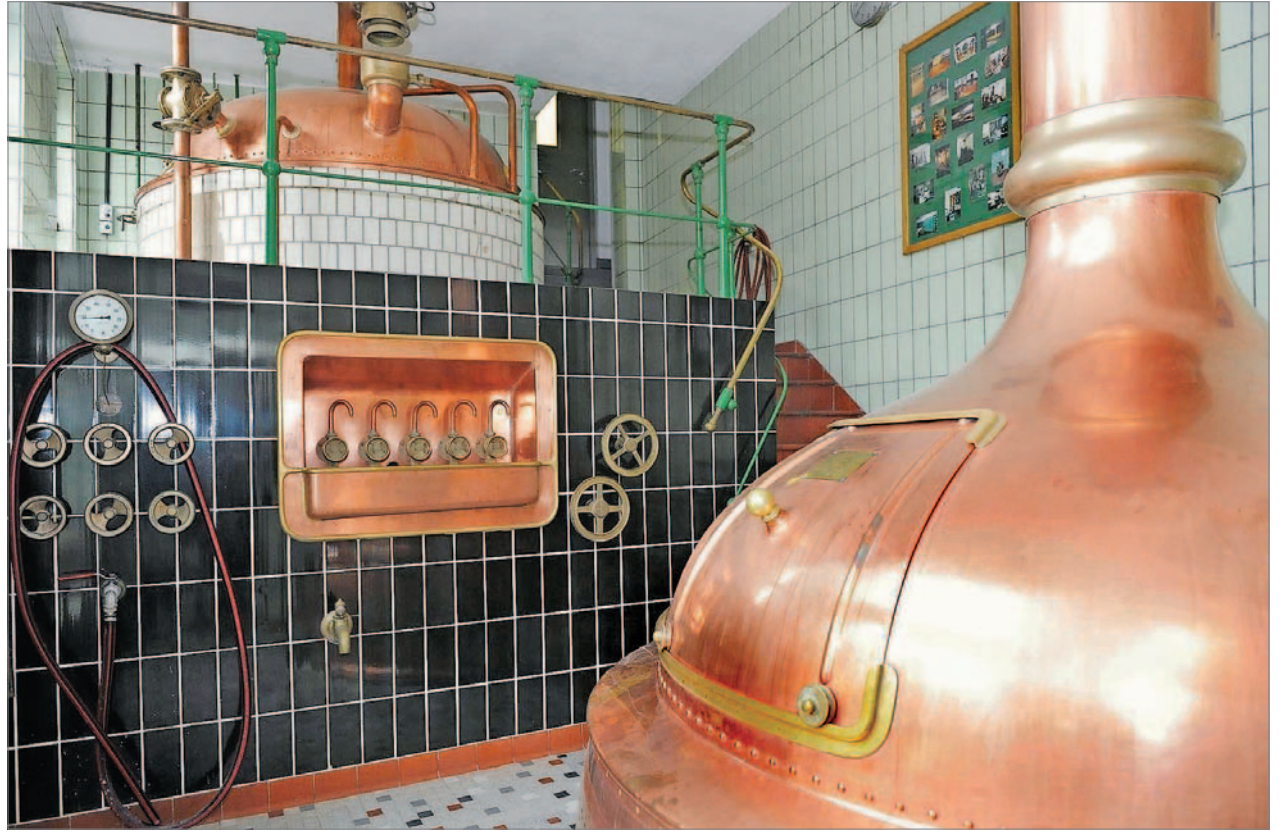
Das Sudhaus der Traditionsbrauerei mit den ursprünglichen Kupferkesseln stammt aus dem Jahr 1932 – doch unter der Metallhaut verbirgt sich heute moderne, computergesteuerte Brautechnik.
